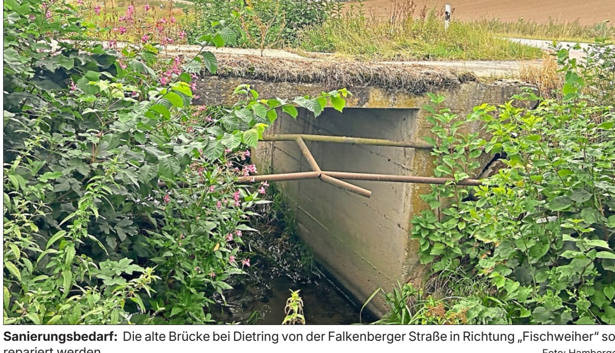
Sanierungsbedarf: Die alte Brücke bei Dietring von der Falkenberger Straße in Richtung „Fischweiher“ soll repariert werden. – Foto: Hamburger
